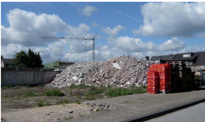
Im Dahlkamp/Grüner Weg entsteht ein privates Wohnbaugebiet. Für die schon begonnene Verlagerung des Betriebes war ein erneuter Ratsbeschluss notwendig.
